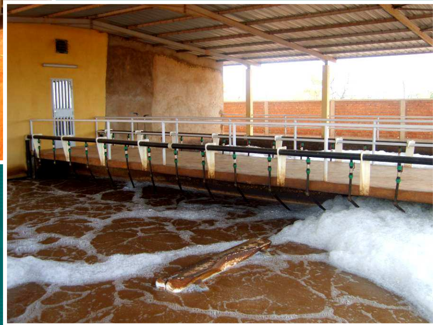
Traitement des eaux usées
